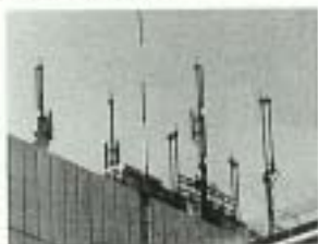
図2.29 デパート屋上の 携帯電話基地局アンテナ
