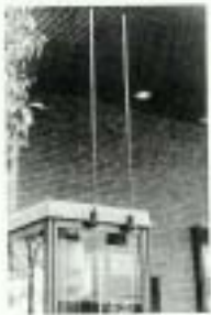
図2.25 電線ボックス設置型の 基地局アンテナ
